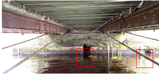
Bild 2 Visar de två gjutsår på norra sidan.
