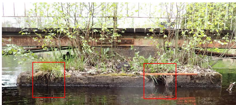
Bild 4 Visar sprickorna på östra kortsidan
