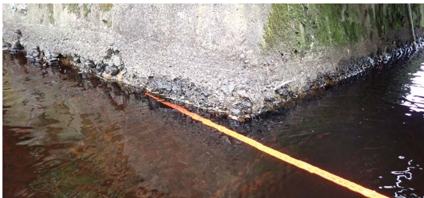
Bild 5 Visar Vittring samt underspolning i det östra hörnet
