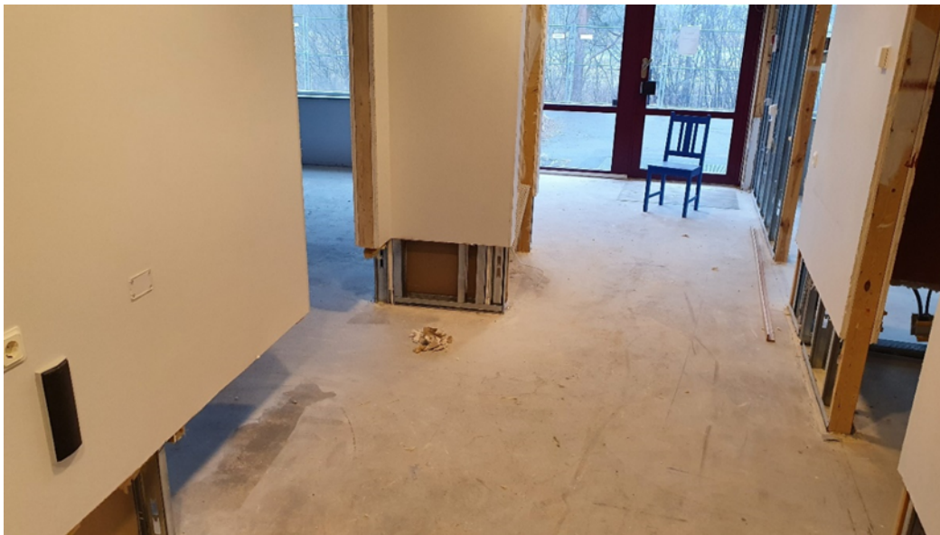
Bild: Slipat betonggolv och avkapade fuktskadade innerväggar.
