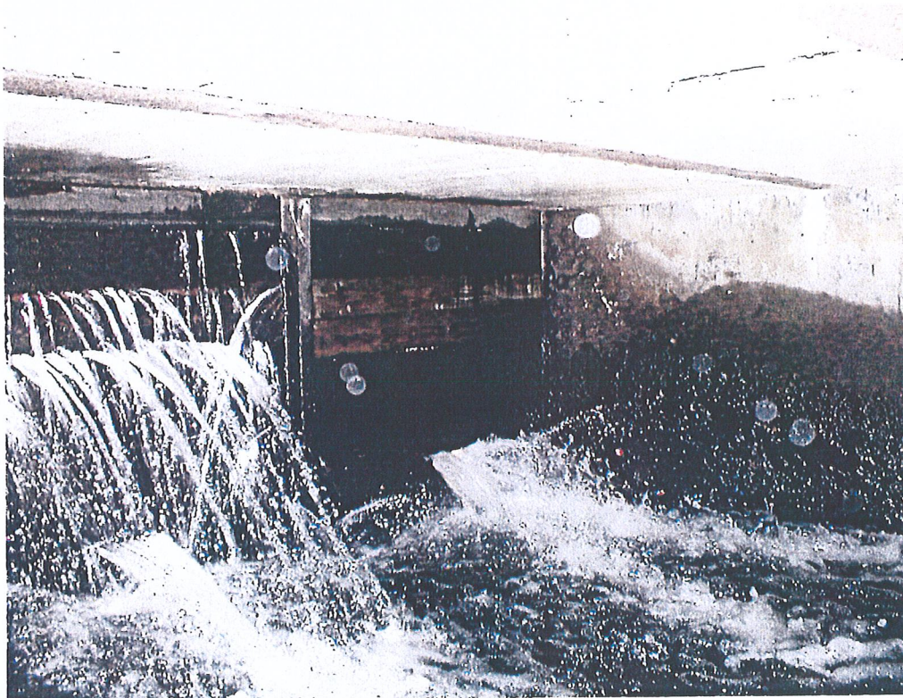
Bild 3.5. Läckage från utskov. Läckage genom vägbank förekommer i mindre omfattning.
