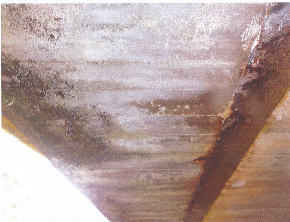
Bild 1: Läckage och kalkutfällning i broplatta
