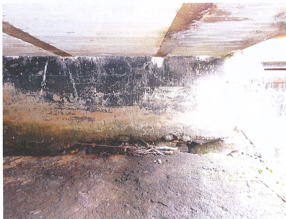
Bild 3: Södra frontmuren saknar anliggning mot botten.
