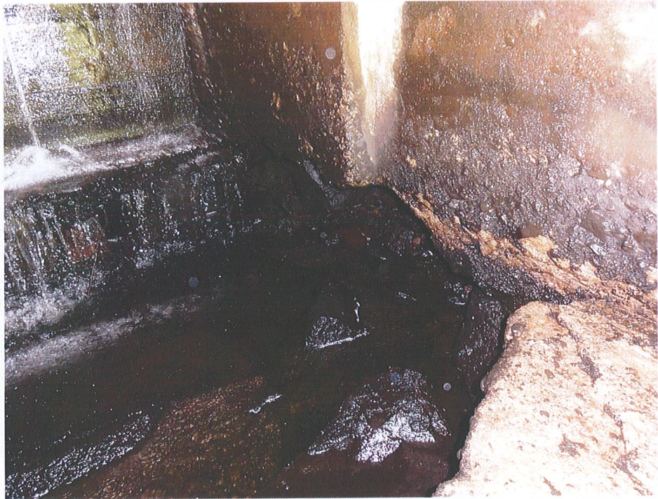
Bild 4: Södra frontmuren. Dåligt upplag mot botten.
