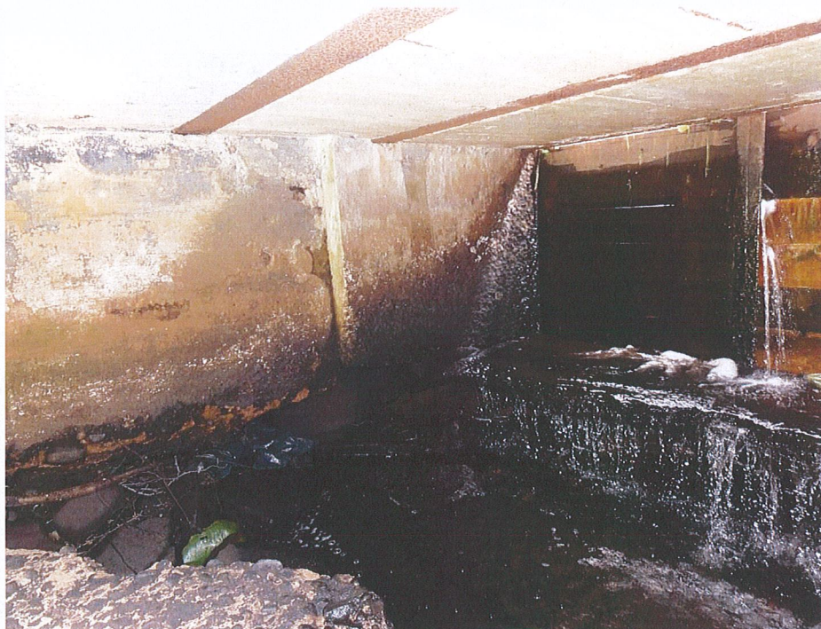
Bild 5: Norra frontmuren. Dåligt upplag mot botten. En stor del av betongplattan har lossnat.
