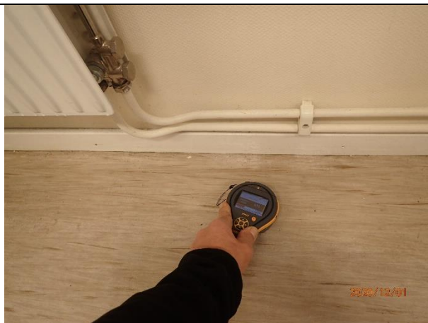
Mätvärde 431 mätt med Protimeter MM2 fuktindikator vid yttervägg innaför fuktpåslag.
