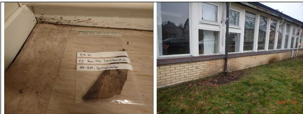
Prov 5, träfiberskiva under plastmatta i rum147 med bristfällig takavvatning som fuktbelastar fasad och bottenplatta.
