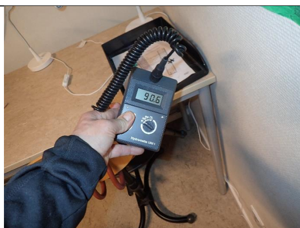
Förhöjt fuktvärde i rum 145 där det finns missfärgning i fasad .
