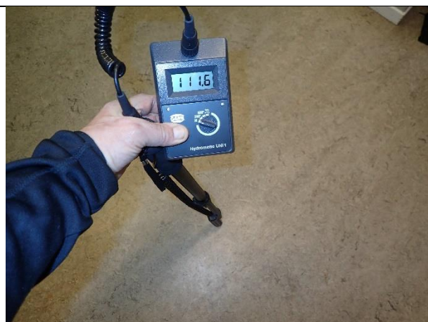
Förhöjt fuktvärde mellan gammalt och tillbyggt golv i kapprum 119.
