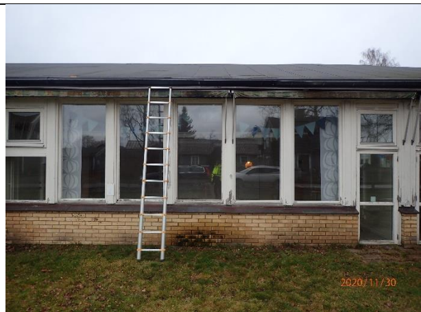
Fuktpåslag i fasad på grund av otät skarv på hänggränna, vatten droppar ner och skvätter upp på fasad. Utanför rum 144 som står tomt.
