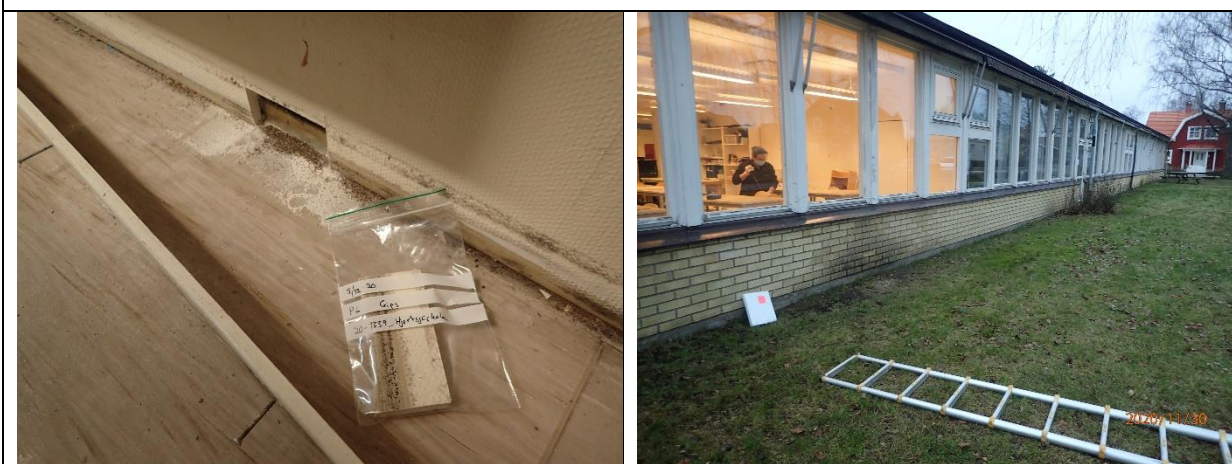
Prov 8, Gips i yttervägg rum 154 där det är en svacka på hänggränsen utvändigt.
