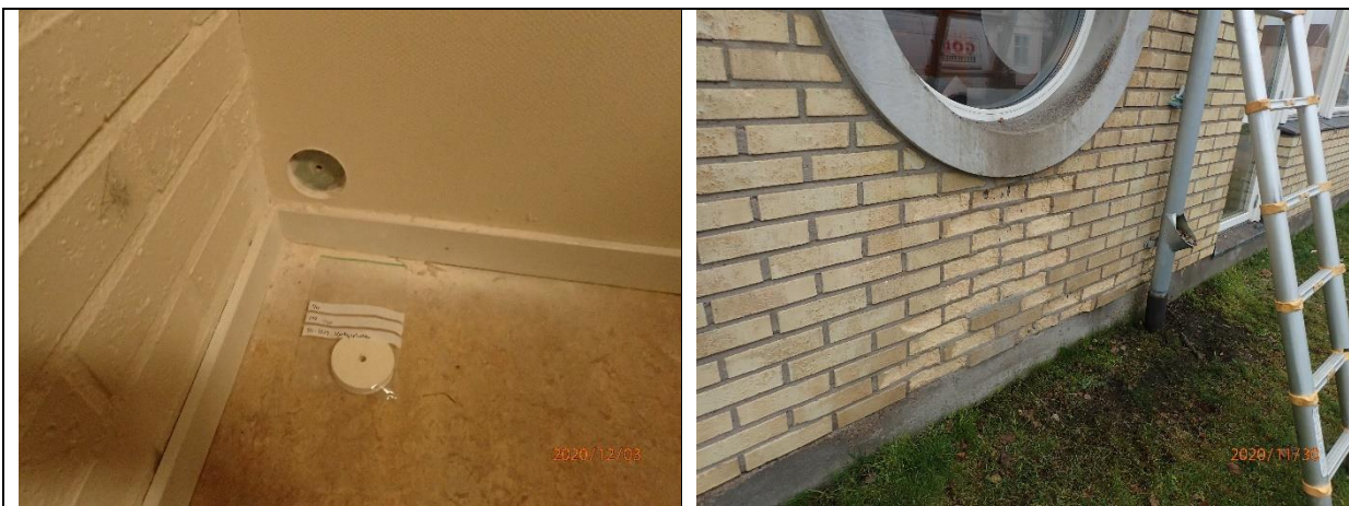
Prov 12, Gips i yttervägg rum 105 där stuprör är igensatt och fasaden frostspräng.
