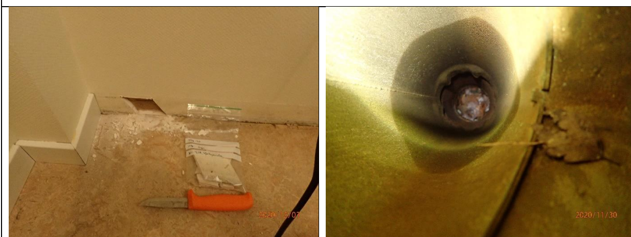
Prov 16, Gips och tjärpapp i yttervägg rum 130 med igensatt takavattning utvändigt.
