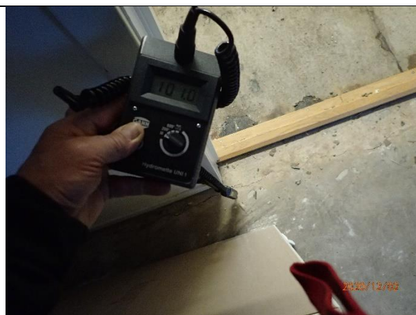
Förhöjt fuktvärde vid dörr till rum 105 i skarv mellan gammalt och tillbyggt golv.
