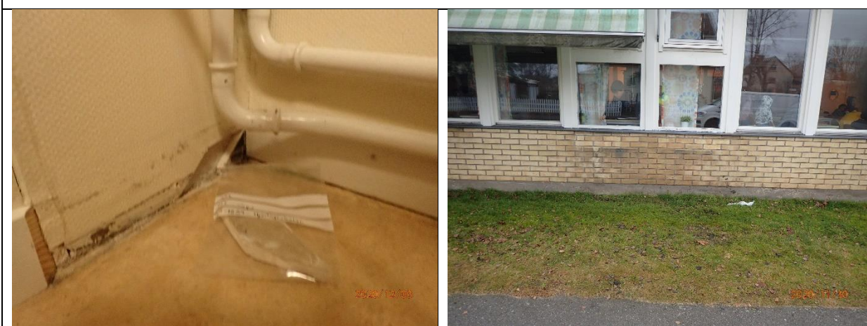
Prov 14, Gips i mellanvägg rum 115 som ansluter mot yttervägg där det är en svacka på hängrännan som orsakat att vatten stänkt upp på fasaden med uppfuktning som följd.
