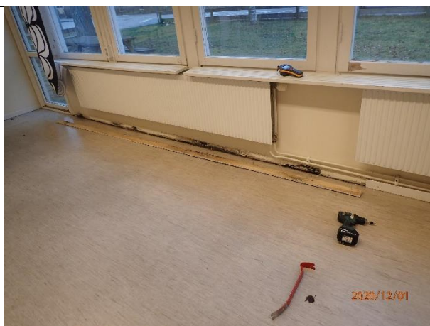
Kraftig påväxt på golvsockel och vägg.
