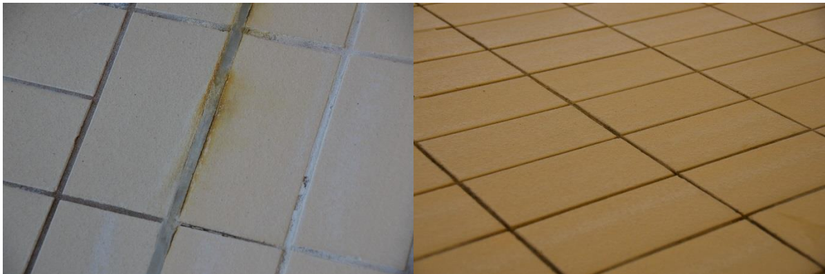
Klinker i bassängutrymmet
