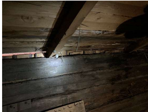
Läckagen är synliga från insidan och bör åtgärdas omgående.
