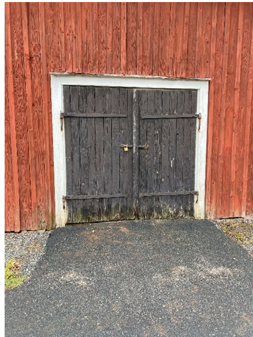
Den höga marknivån och asflatsytorna nära byggnaden bidrar till oönskad fuktbelastning på fasad och dörrar.
