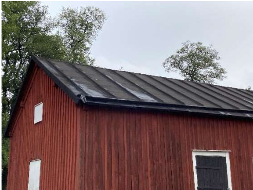
Papptaket har några mindre skador. Samtliga läckage tycks finnas utmed takfotsrännan.
