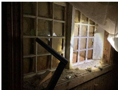
Samtliga fönster är förtäckta av skivor. Fönsterbågarna är i behov av renovering.
