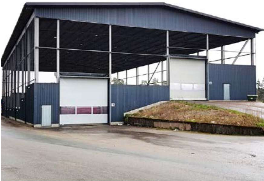
Foto på omlastningshallen i Gislaved som är inbyggd med plåt, stängsel och automatiska portar.
