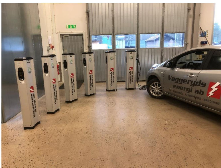
6 st nya laddstolpar på väg ut i laddinfrastrukturen. (foto Krister Lundgren)
