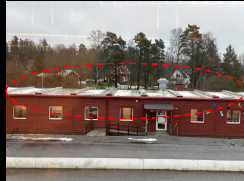
Paviljongens tak är platt med svag avrinning varför huset har problem med inläckage
